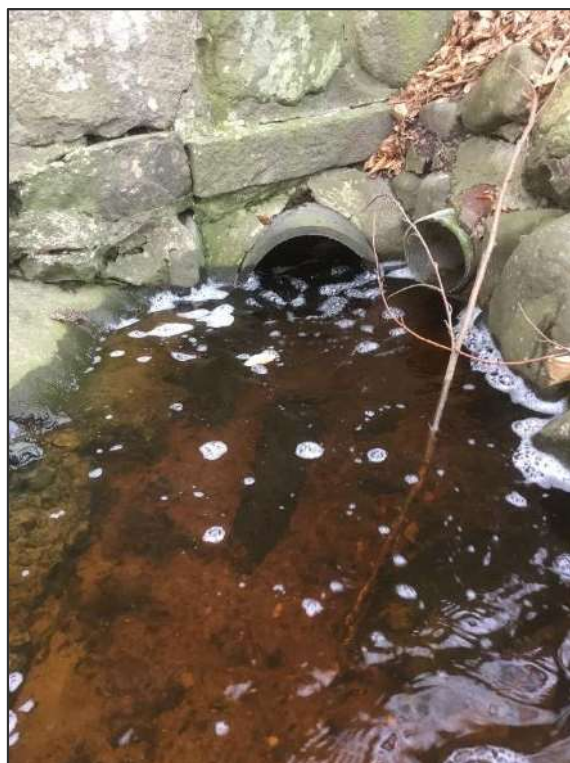
Figur 6-66: Helsingør 6. Rørudløb. Foto er taget ved besigtigelse den 4. april 2023.
