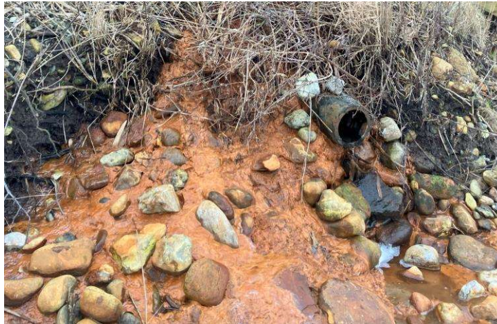
Figur 6-24: Plantagevej 1. Rørlagt vandløbs udløb. Foto er taget af Gribskov Kommune den 04. februar 2025.
