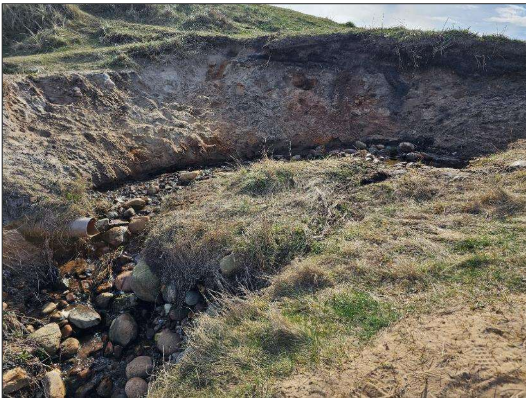
Figur 6-28: Der stak et Ø150 PVC-rør ud ved den eroderede kanal. PVC-røret var ikke vandførende.
